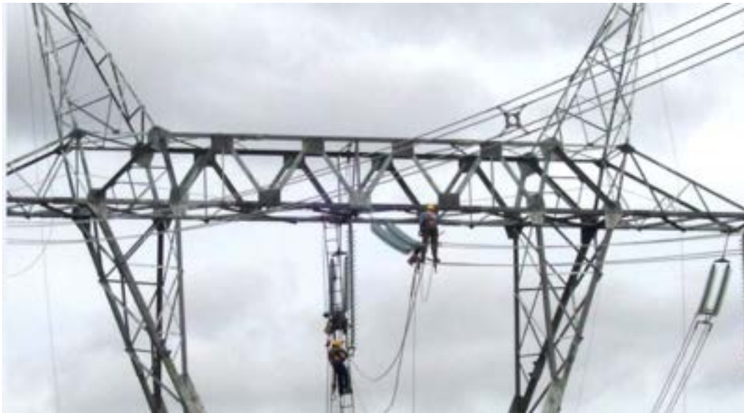
Línea de Extra Alta Tensión 500 kV –Gral. Rodríguez- Buenos Aires – Argentina
